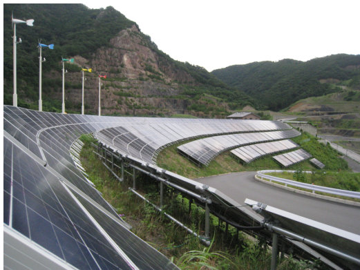
小俣の足利市最終処分場に隣接する 大規模太陽光発電施設。
